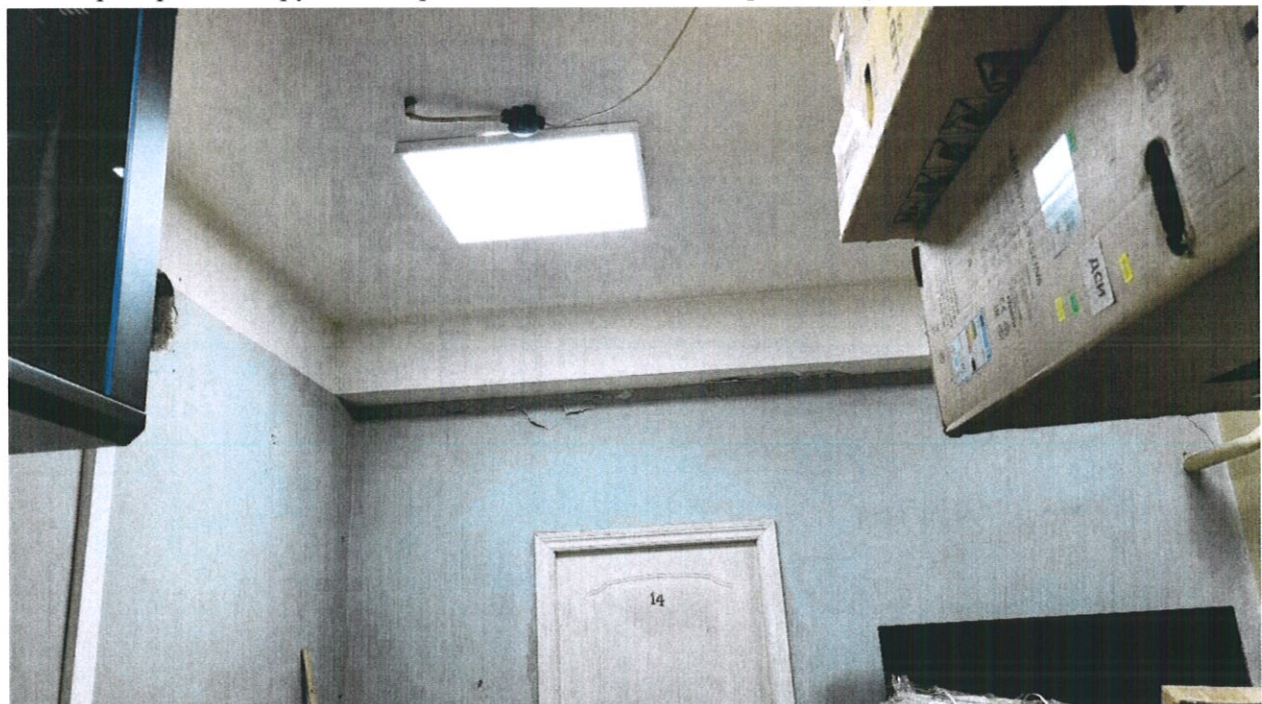
Фото № 67. В техническом помещении на уровне первого этажа на поверхности каменной стены раскрылись крупные горизонтальные и косые трещины усадочного характера.
