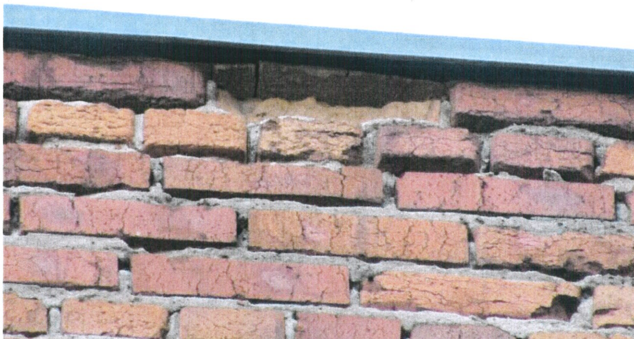
Фото № 68. В торце здания кирпичи каменной кладки наружной стены местами потрескались и раскололись.
