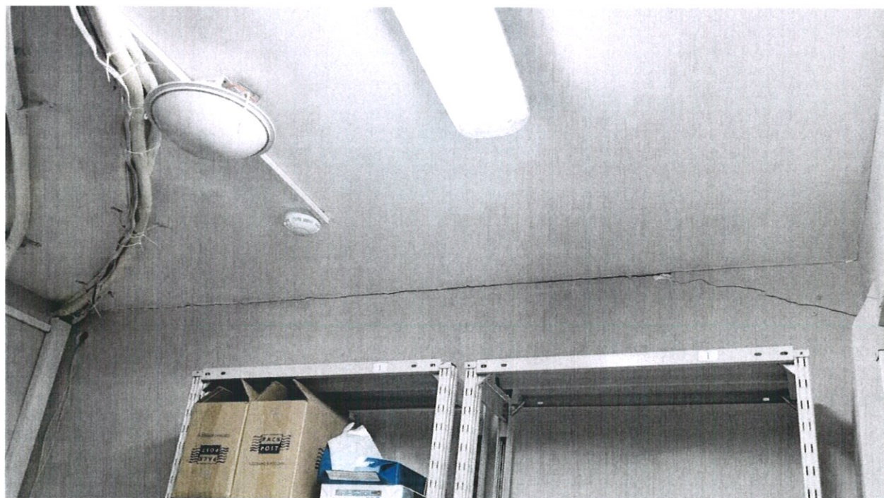
Фото № 20. В помещении архива ФКУ «Дороги России» на уровне первого этажа на поверхности каменной стены раскрылись крупные горизонтальные и косые трещины усадочного характера.
