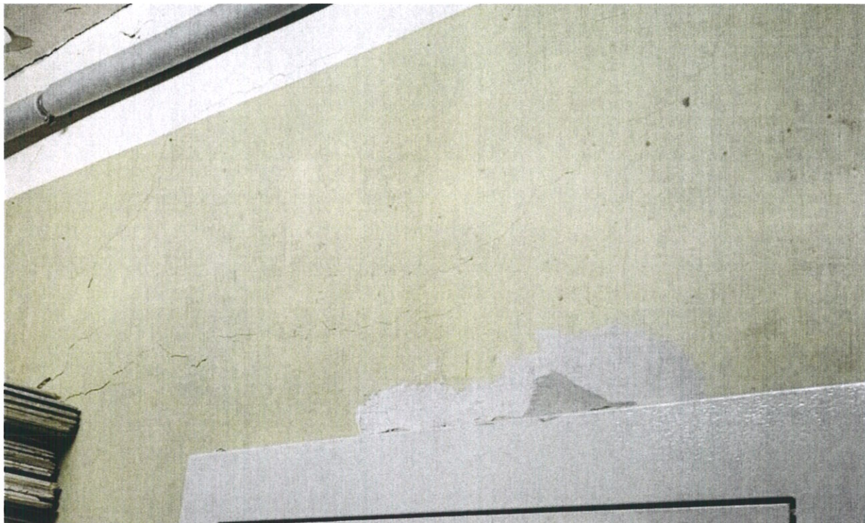
Фото № 55. В техническом помещении на уровне первого этажа на поверхности каменной стены раскрылись крупные горизонтальные и косые трещины усадочного характера.
