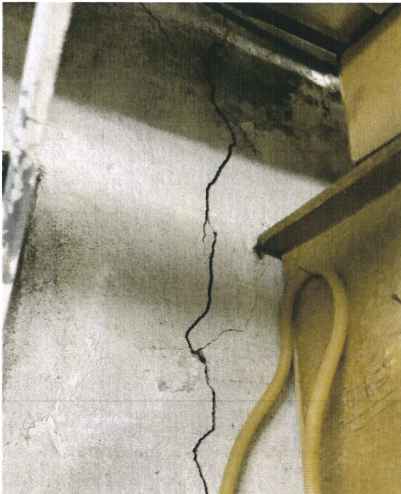
Фото № 45. В помещении теплового пункта на уровне первого этажа на поверхности каменной стены раскрылись крупные вертикальные и косые трещины усадочного характера.
