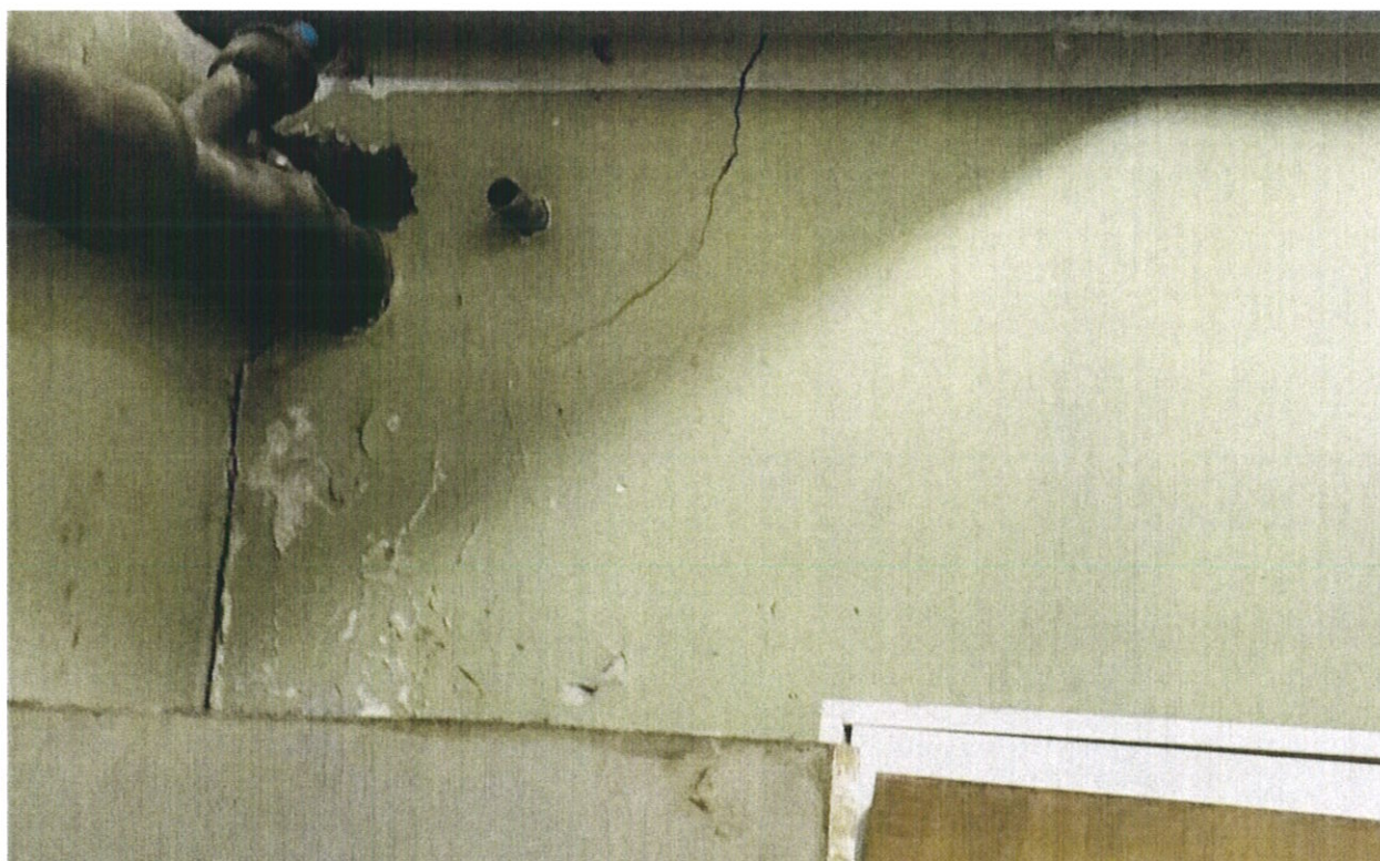
Фото № 56. В техническом помещении на уровне первого этажа на поверхности каменной стены раскрылись крупные горизонтальные и косые трещины усадочного характера.
