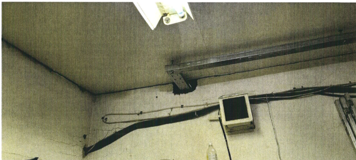
Фото № 64. В техническом помещении на уровне первого этажа на поверхности каменной стены раскрылись крупные горизонтальные и косые трещины усадочного характера.
