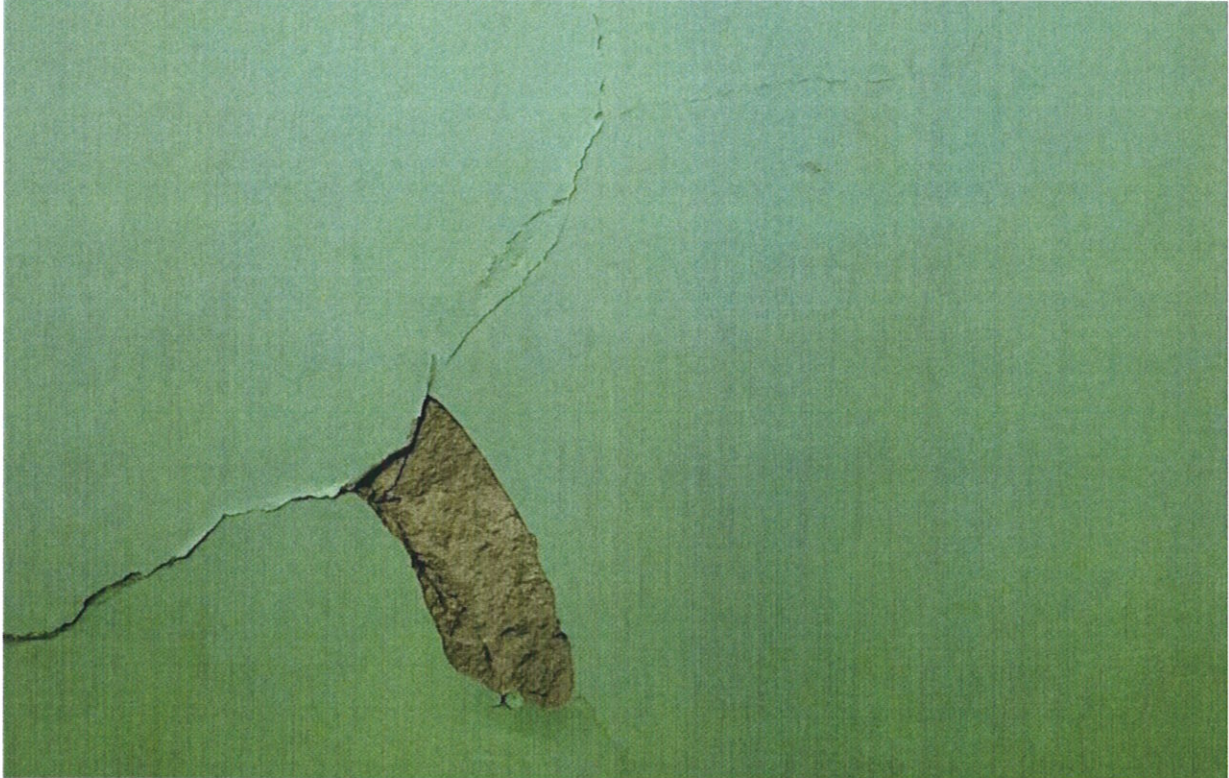
Фото № 8. В помещении междуэтажной лестницы на уровне первого этажа на поверхности каменной стены раскрылись крупные горизонтальные и косые трещины усадочного характера.
