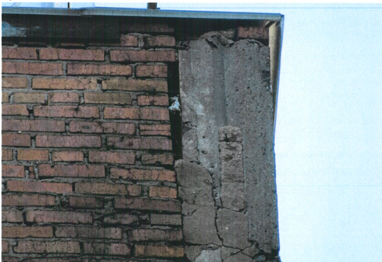
Фото № 69. В торце здания цементная заделка примыканий каменной кладки торцевой стены к железобетонным панелям потрескалась и осыпается.
