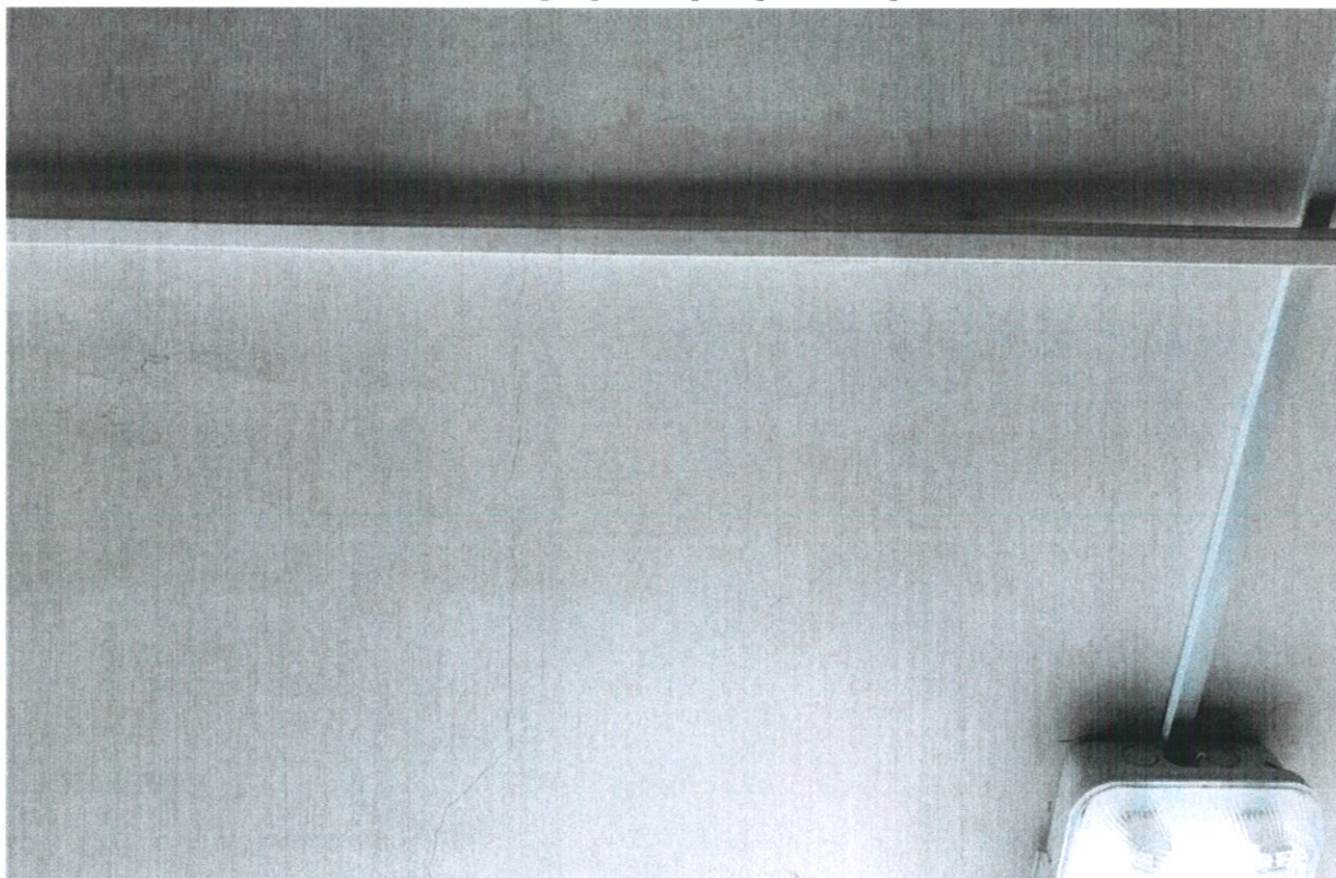
Фото № 30. В помещении архива ФКУ «Дороги России» на уровне первого этажа на поверхности потолка вдоль плит перекрытия раскрылись трещины.
