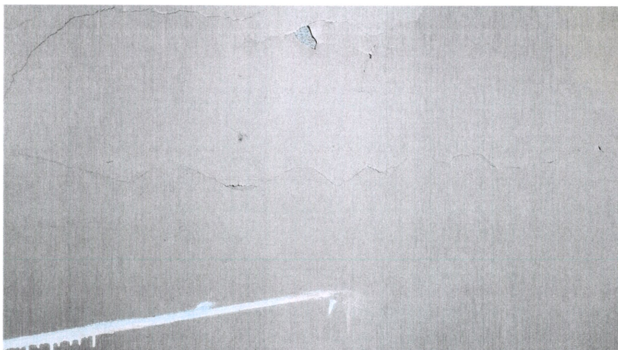
Фото № 36. В помещении междуэтажной лестницы ФКУ «Дороги России» на уровне первого этажа на поверхности каменной стены раскрылись крупные горизонтальные и косые трещины усадочного характера.
