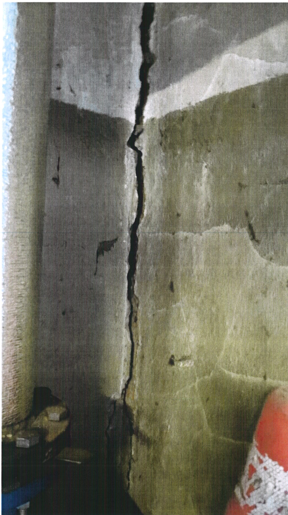
Фото № 48. В помещении теплового пункта на уровне первого этажа на поверхности каменной стены раскрылись крупные вертикальные и косые трещины усадочного характера.
