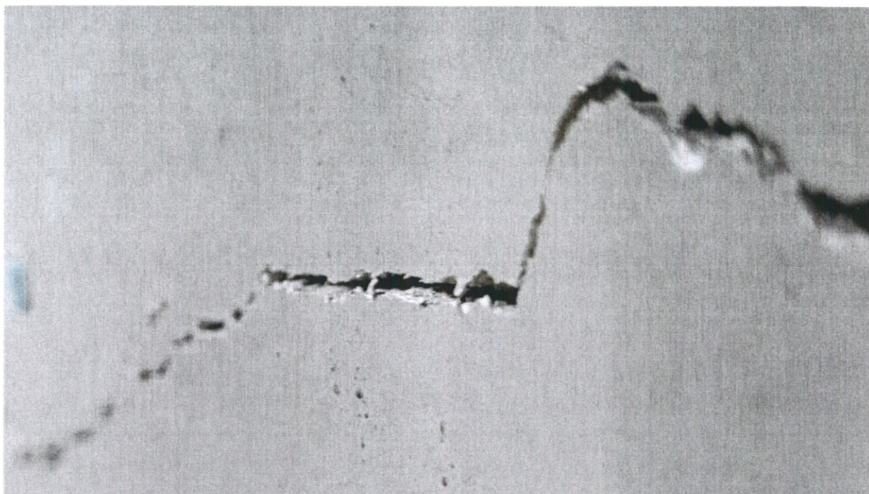
Фото № 43. В помещении междуэтажной лестницы ФКУ «Дороги России» на уровне первого этажа на поверхности каменной стены раскрылись крупные горизонтальные и косые трещины усадочного характера.
