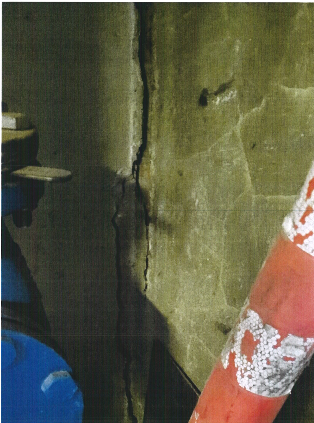
Фото № 50. В помещении теплового пункта на уровне первого этажа на поверхности каменной стены раскрылись крупные вертикальные и косые трещины усадочного характера.
