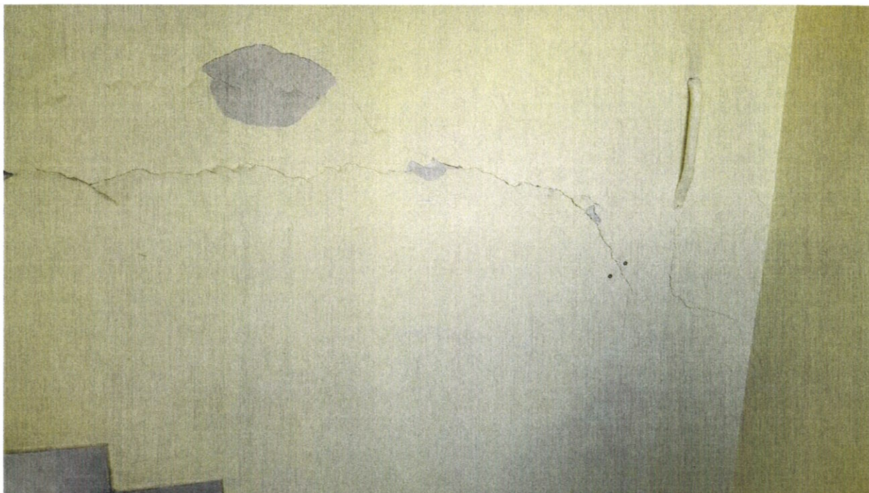
Фото № 33. В помещении междуэтажной лестницы ФКУ «Дороги России» на уровне первого этажа на поверхности каменной стены раскрылись крупные горизонтальные и косые трещины усадочного характера.
