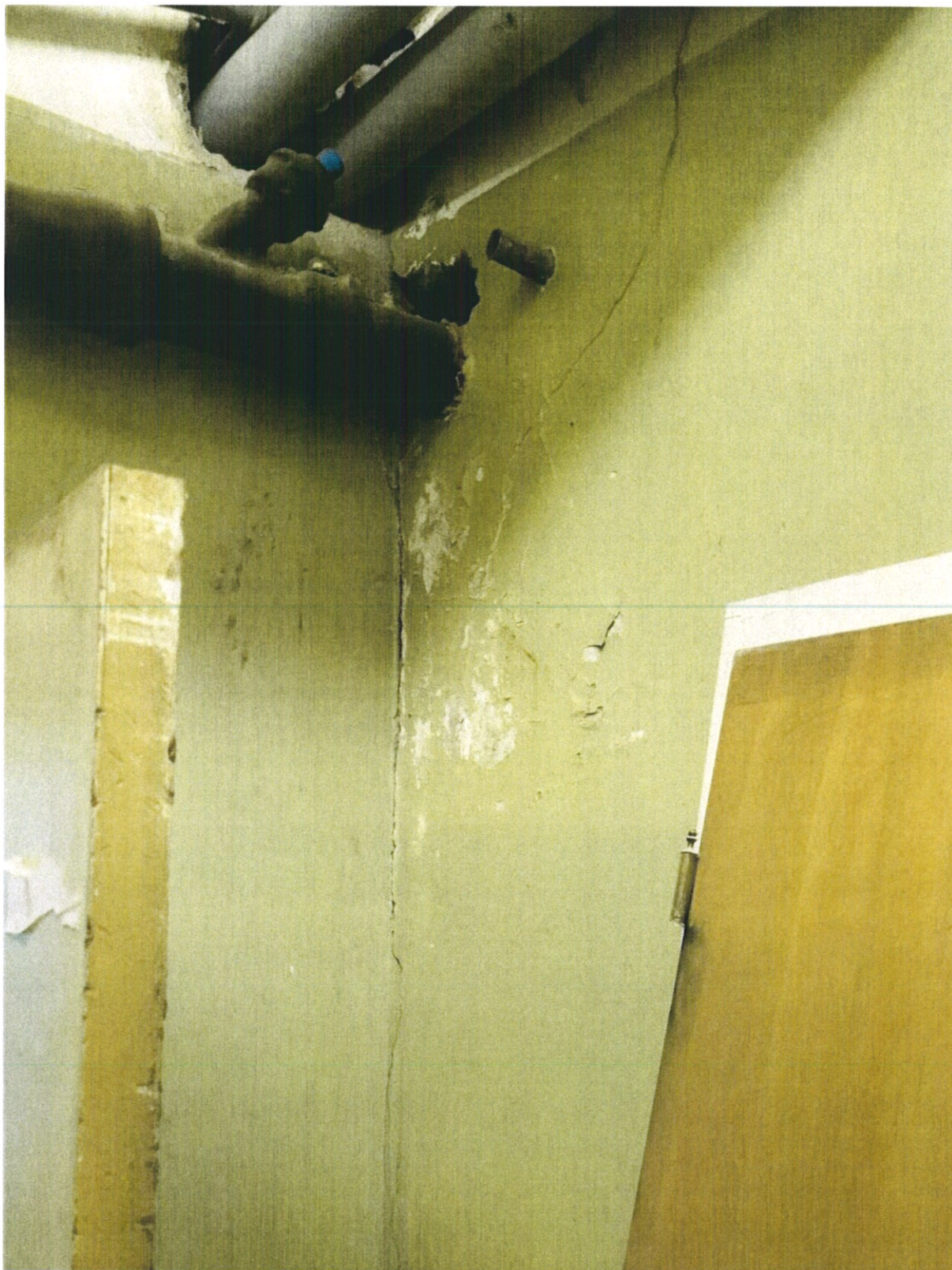
Фото № 59. В техническом помещении на уровне первого этажа на поверхности каменной стены раскрылись крупные вертикальные и косые трещины усадочного характера.
