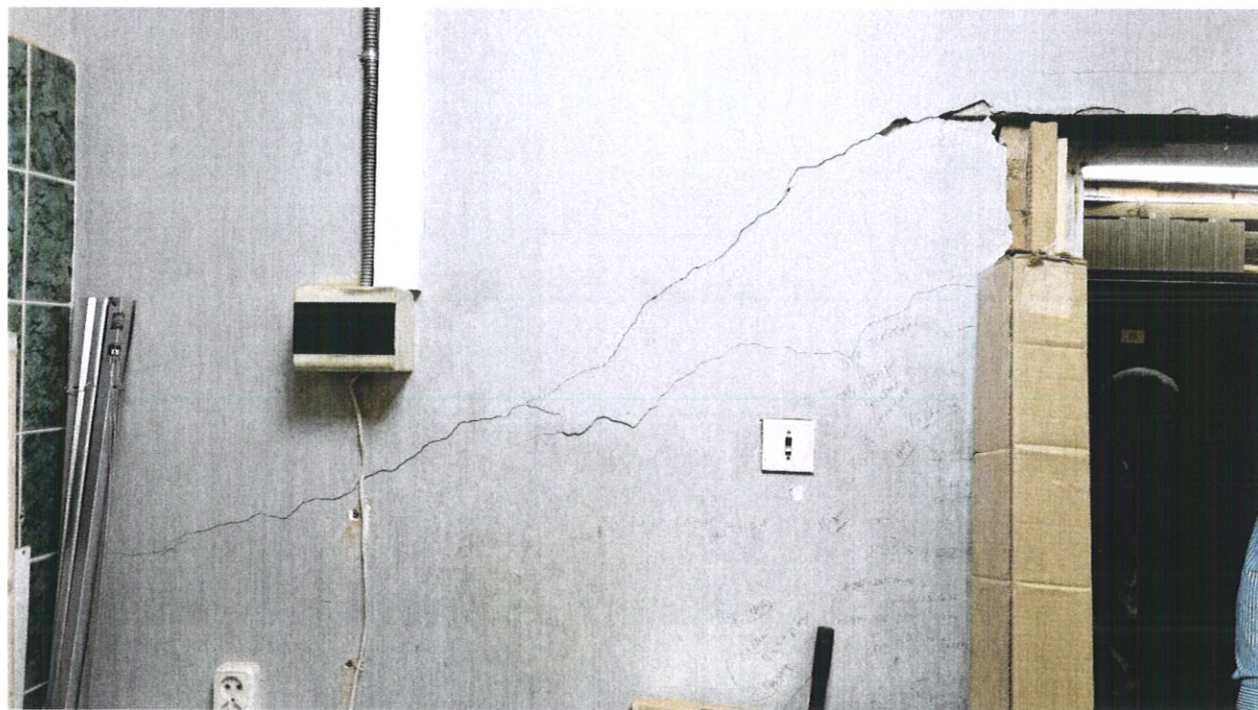
Фото № 54. В помещении 21 на уровне первого этажа на поверхности каменной стены раскрылись крупные горизонтальные и косые трещины усадочного характера.
