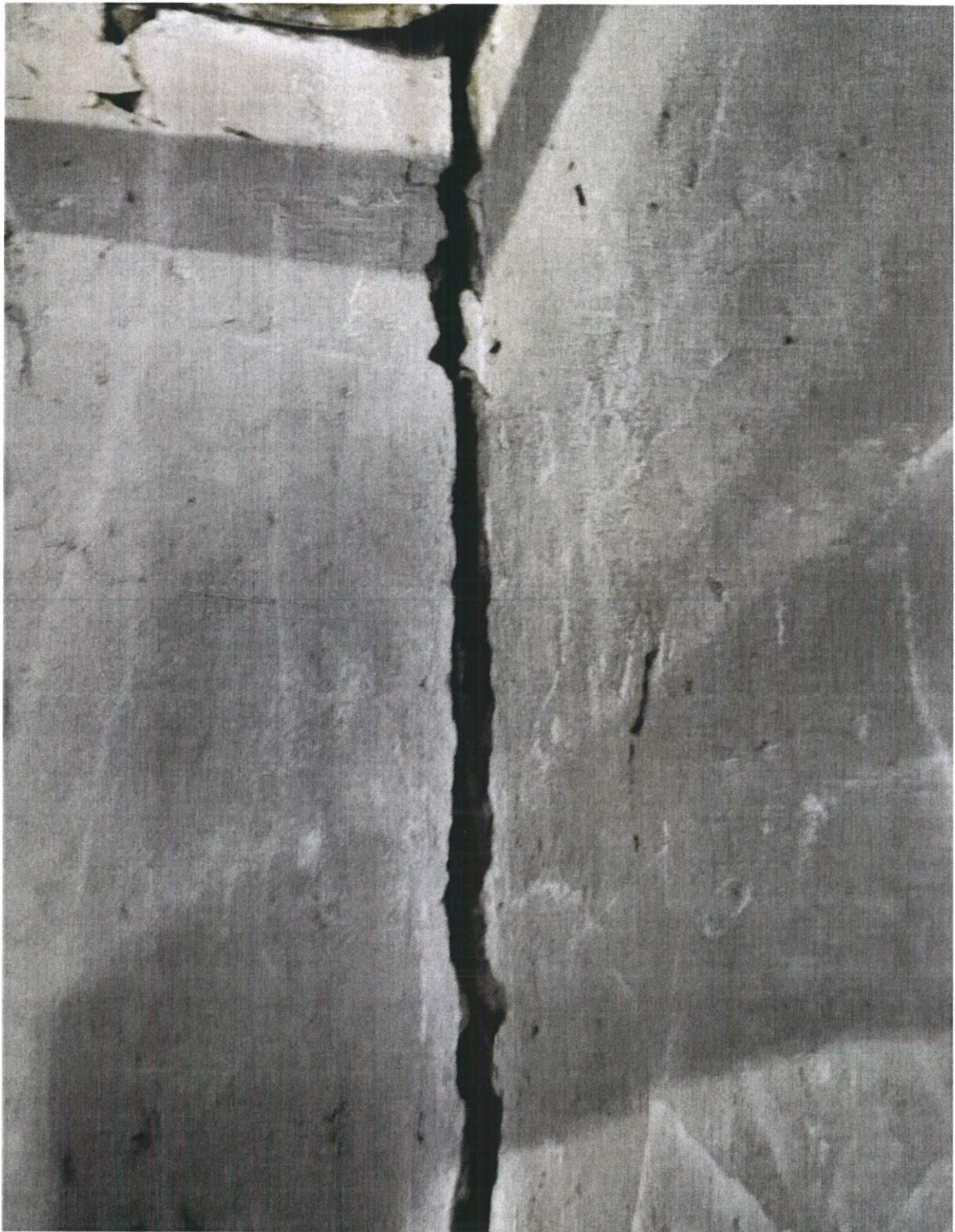
Фото № 49. В помещении теплового пункта на уровне первого этажа на поверхности каменной стены раскрылись крупные вертикальные и косые трещины усадочного характера.
