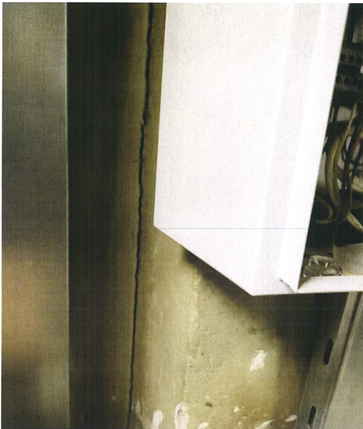
Фото № 47. В помещении теплового пункта на уровне первого этажа на поверхности каменной стены раскрылись крупные вертикальные и косые трещины усадочного характера.
