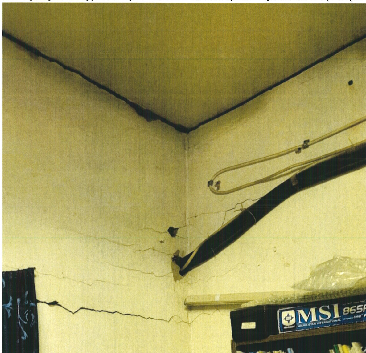
Фото № 65. В техническом помещении на уровне первого этажа на поверхности каменной стены раскрылись крупные горизонтальные и косые трещины усадочного характера.
