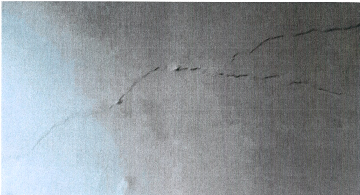
Фото № 41. В помещении междуэтажной лестницы ФКУ «Дороги России» на уровне первого этажа на поверхности каменной стены раскрылись крупные горизонтальные и косые трещины усадочного характера.
