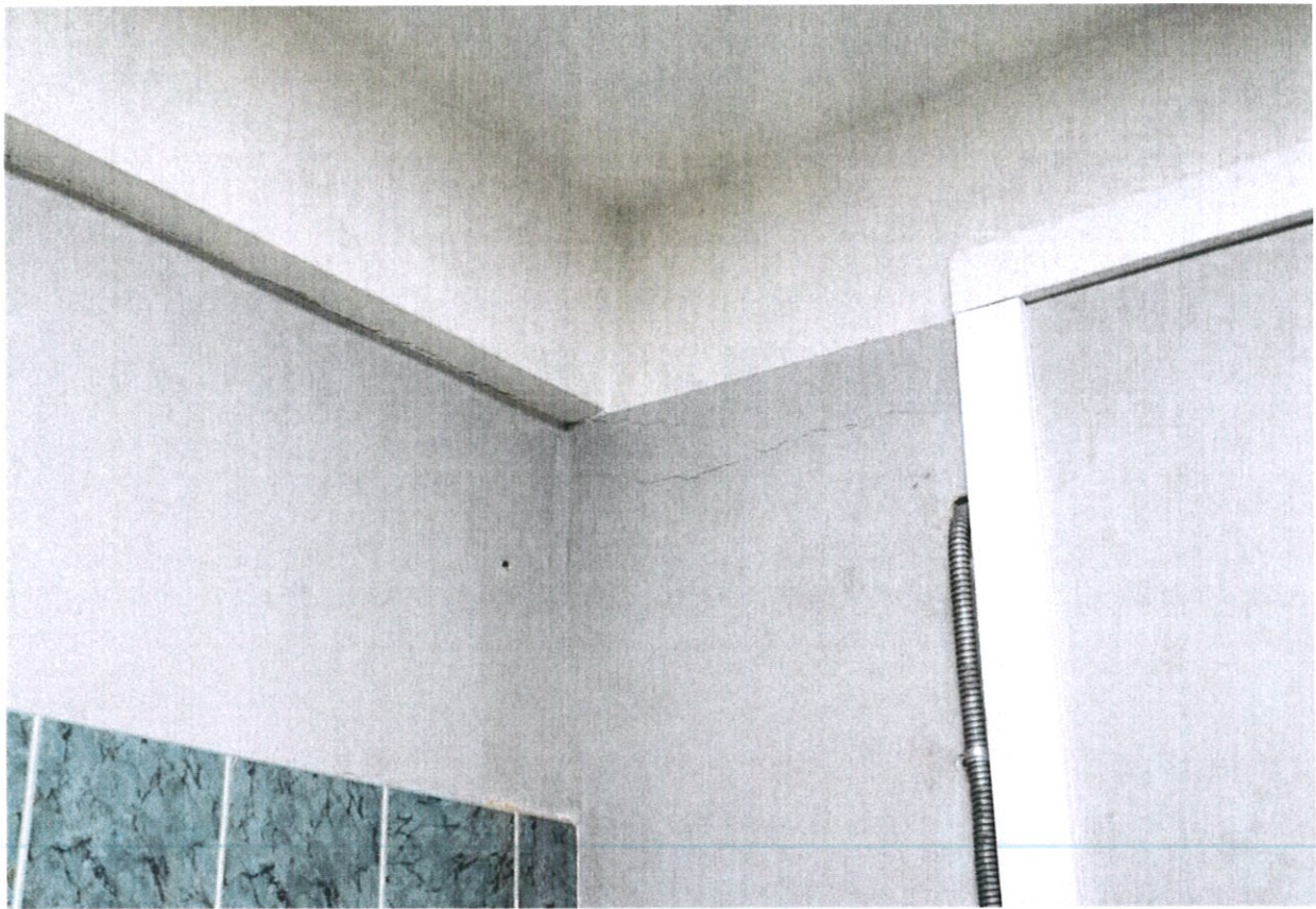
Фото № 66. В техническом помещении на уровне первого этажа на поверхности каменной стены раскрылись крупные горизонтальные и косые трещины усадочного характера.
