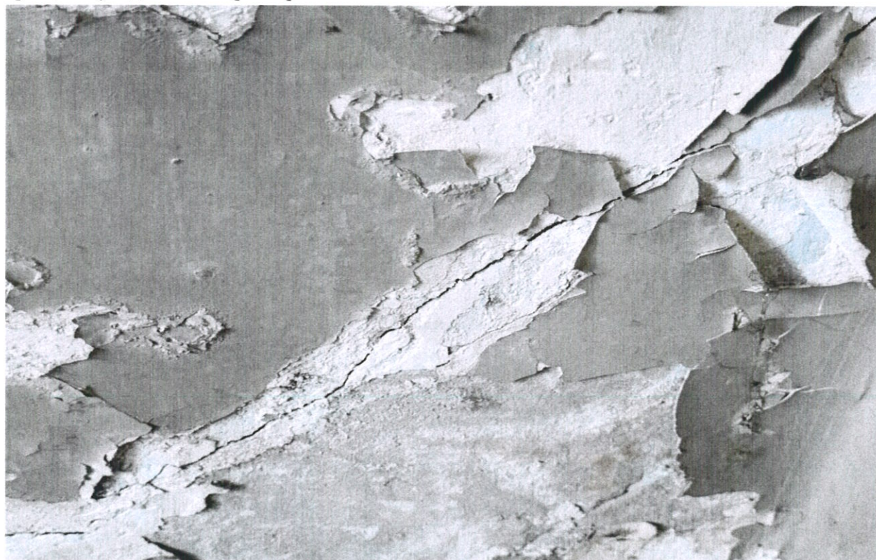
Фото № 44. В помещении междуэтажной лестницы ФКУ «Дороги России» на уровне первого этажа на поверхности каменной стены раскрылись крупные горизонтальные и косые трещины усадочного характера.
