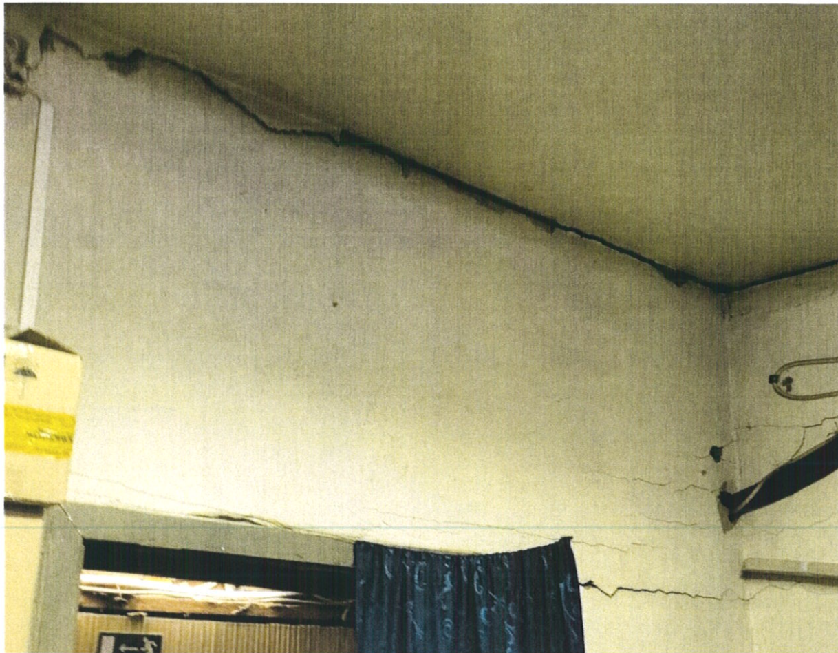
Фото № 62. В техническом помещении на уровне первого этажа на поверхности каменной стены раскрылись крупные горизонтальные и косые трещины усадочного характера.
