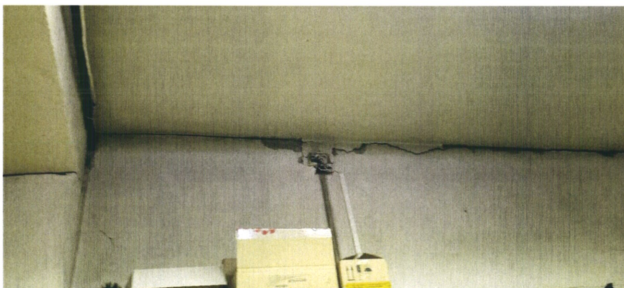
Фото № 63. В техническом помещении на уровне первого этажа на поверхности каменной стены раскрылись крупные горизонтальные и косые трещины усадочного характера.
