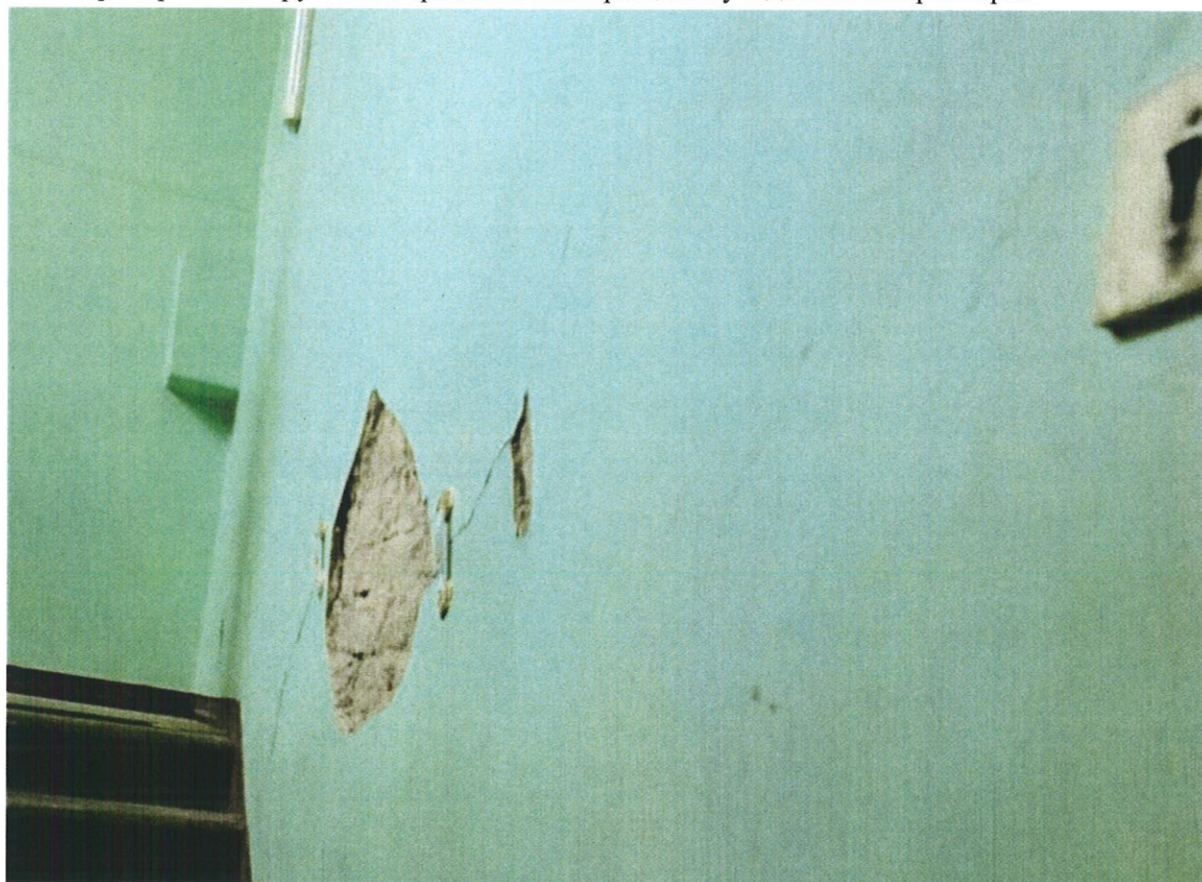
Фото № 6. В помещении междуэтажной лестницы на уровне первого этажа на поверхности каменной стены раскрылись крупные горизонтальные и косые трещины усадочного характера.
