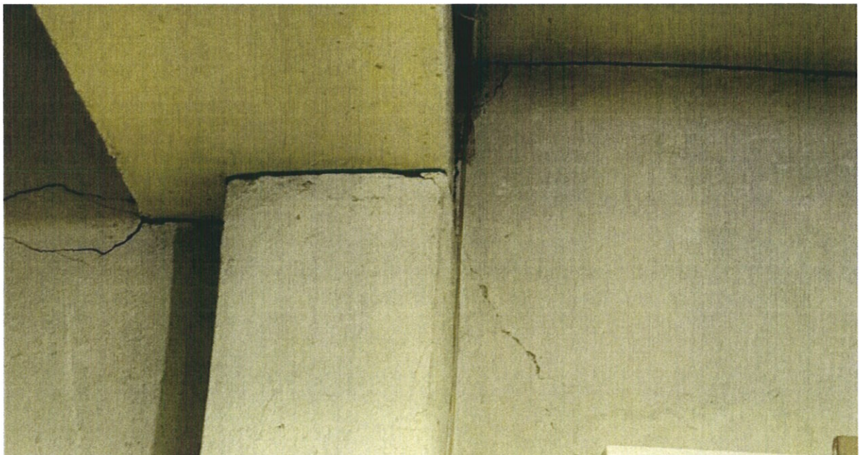
Фото № 60. В техническом помещении на уровне первого этажа на поверхности каменной стены раскрылись крупные горизонтальные и косые трещины усадочного характера.
