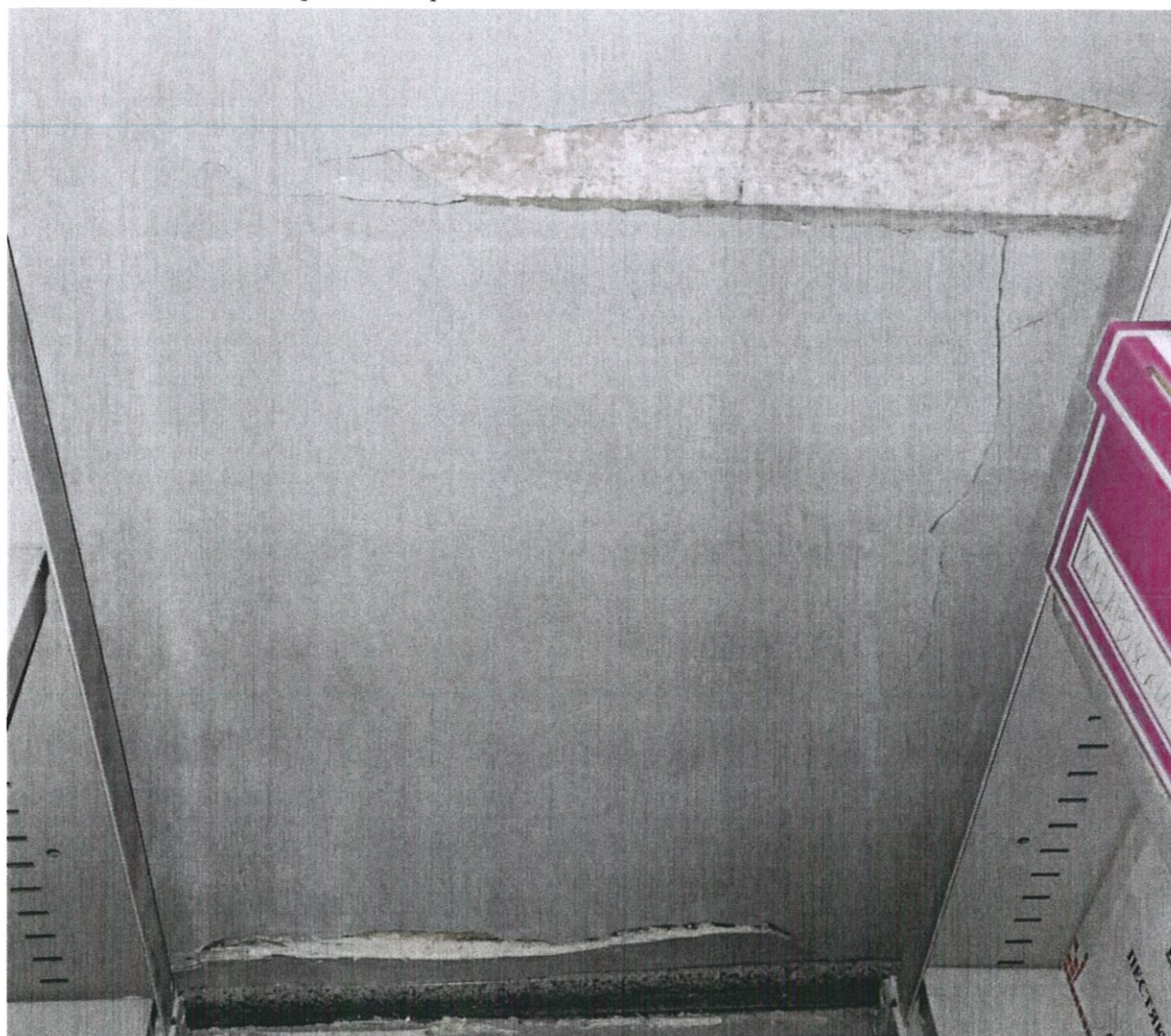
Фото № 16. В помещении архива ФКУ «Дороги России» на уровне первого этажа на поверхности каменной стены раскрылись крупные горизонтальные и косые трещины усадочного характера.
