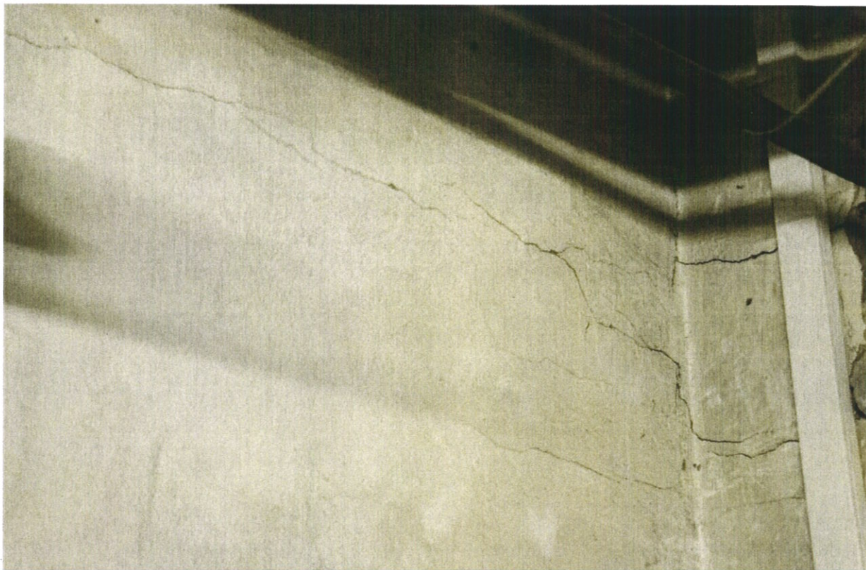
Фото № 51. В помещении 21 на уровне первого этажа на поверхности каменной стены раскрылись крупные горизонтальные и косые трещины усадочного характера.
